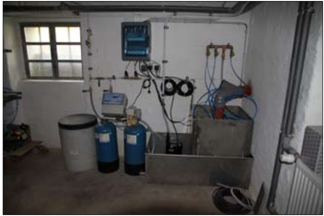
Die Installationen im Keller
